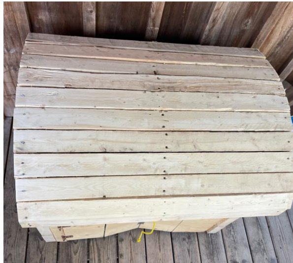
Figure 19 : La surface du cache poubelle qui n'est pas scellé
